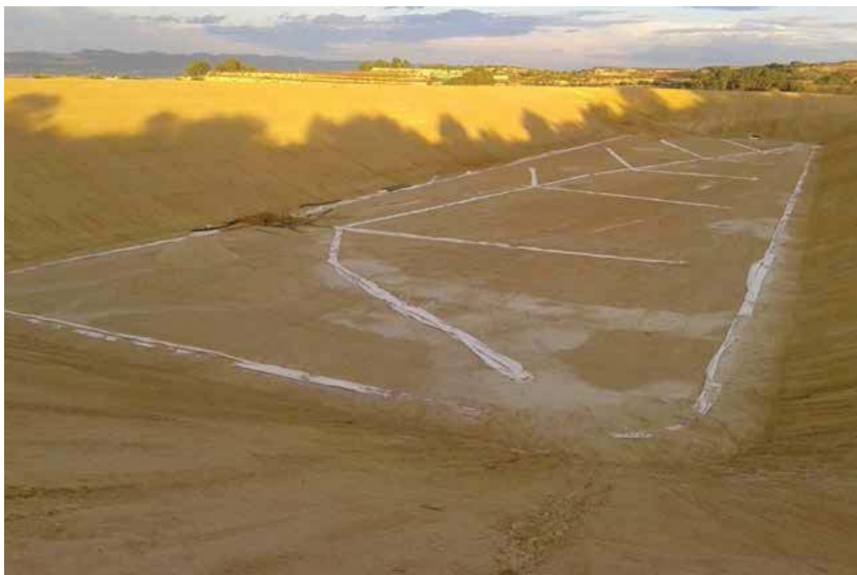
Figura 1. Dren de cintura y red ramificado para el control de fugas en los taludes y el fondo del vaso de una balsa, respectivamente.
